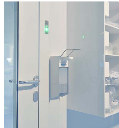
Einbausituation mit Schleusenfunktion und Ampelanzeige
