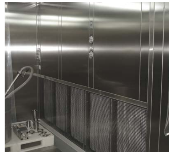
Rückluftgitter in Edelstahl-Wiegekabine
