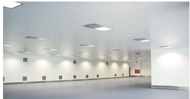
Beleuchtungssystem EBL im clean-ceil Deckensystem
